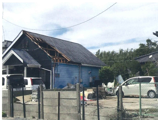
(屋根だけでなく、手前のブロック塀も倒壊)
